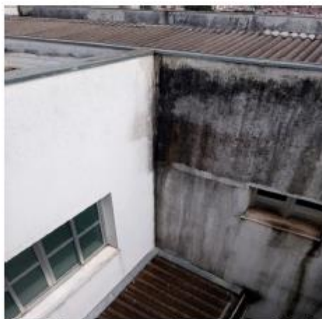
Foto 9: Paredes externas mofadas e presença de bolor
