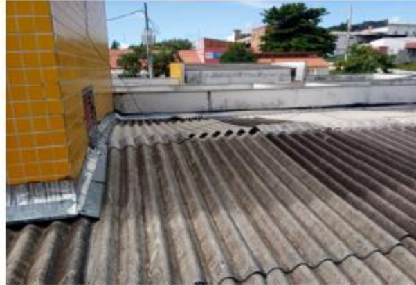
Foto 4: Visão geral da área crítica da cobertura com telhas emendadas, engradamento flambado ao centro prejudicando sua inclinação e conseqüente acúmulo de água favorecendo infiltrações na laje e forro.
