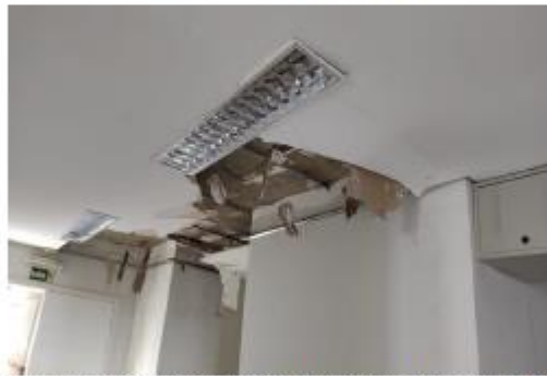
Foto 5: Teto com forro danificado devido a infiltrações no telhado.
