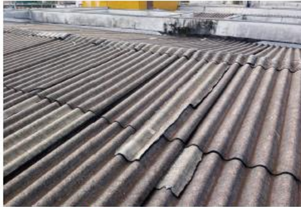
Foto 1: Detalhe Telhas quebradas e remendos.
